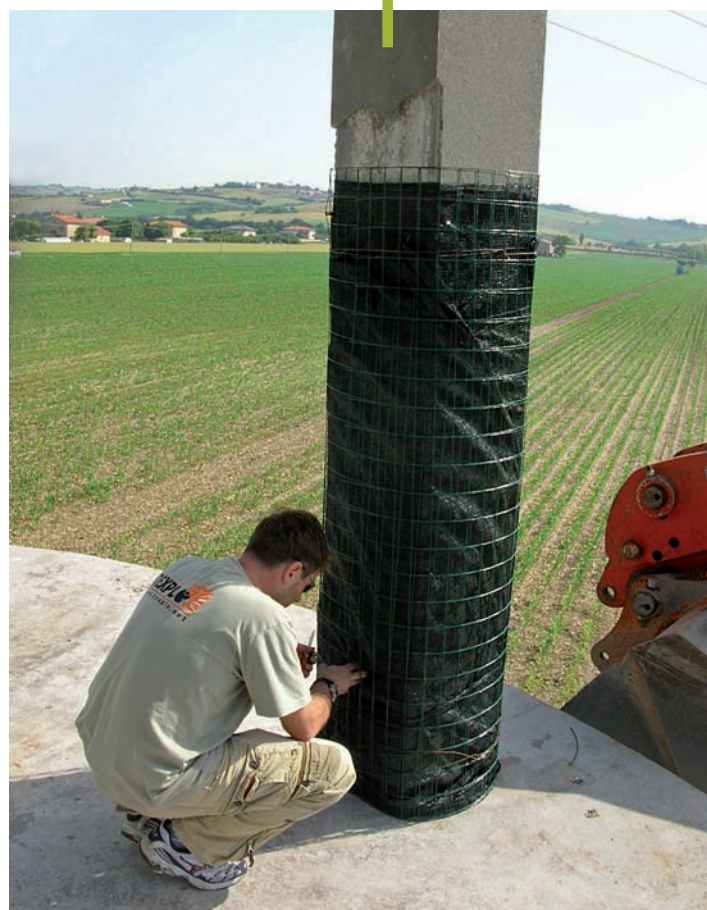
L'apposizione dei teli in geotessuto ad alto peso specifico è coincisa con il termine delle operazioni di caricamento. Le reti metalliche aiutano il tessuto nel contenimento delle schegge di piccola e grande dimensione
