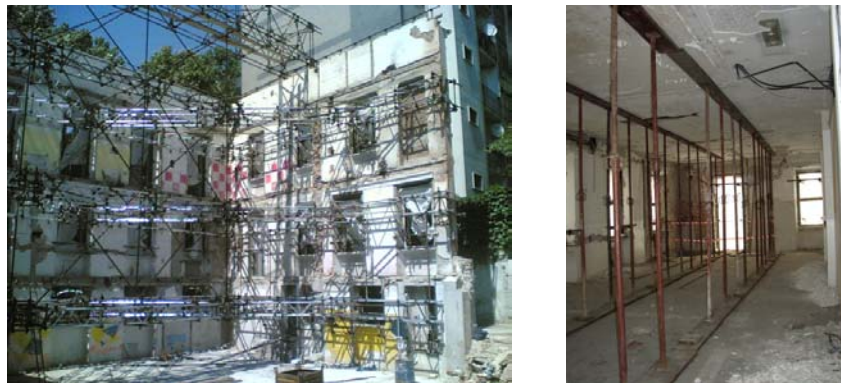
Figura 3. Esempio di smontaggio delle strutture interne di una palazzina in pieno centro storico con facciate soggette a vincolo architettonico e realizzazione di un'opera provvisoria di sostegno delle parti rimaste in opera (foto di sinistra). Particolare puntellamento di solai soggetti a carico (foto di destra).
